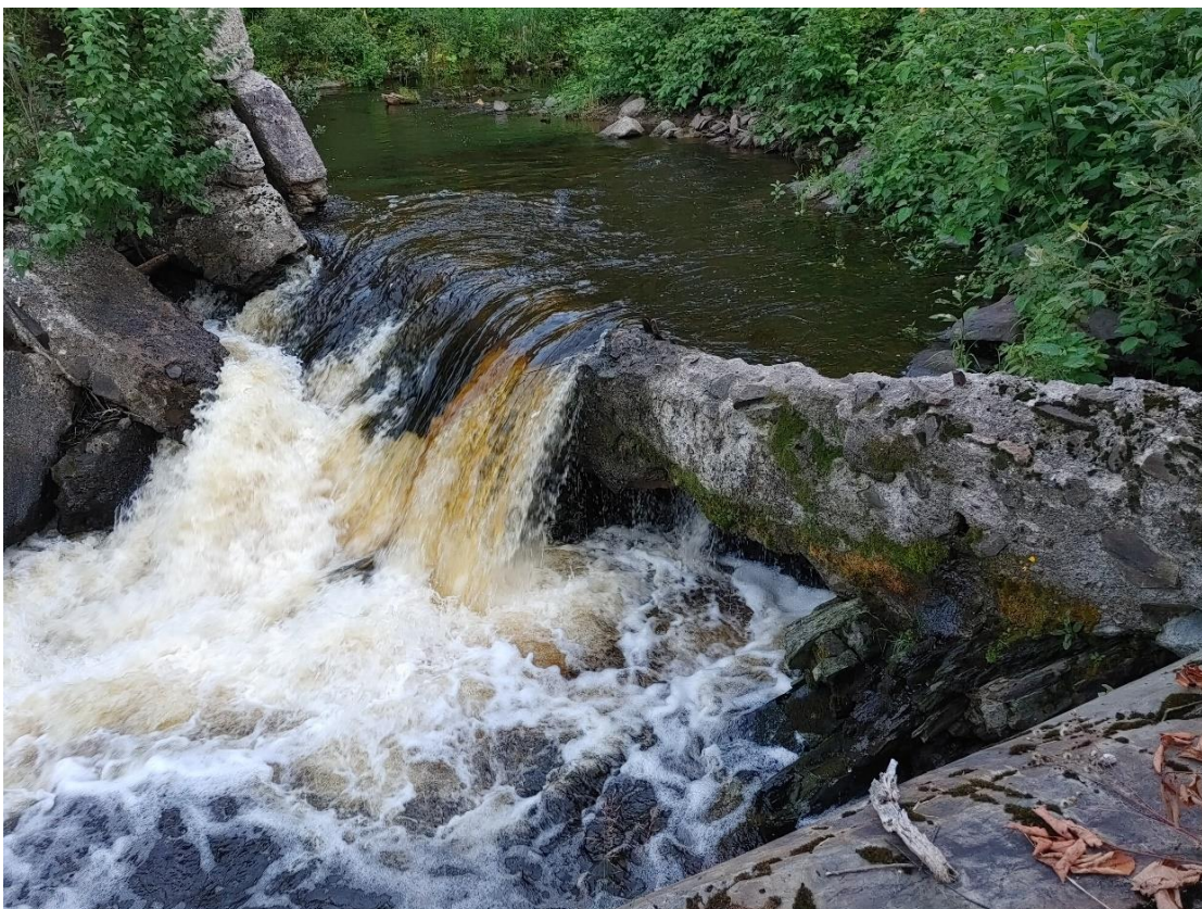
Figure 8. Vue rapprochée du barrage X0000650 de la rivière Cacouna. Il est possible d'observer qu'il existe des fissures dans le barrage (OBAKIR, 2023)
